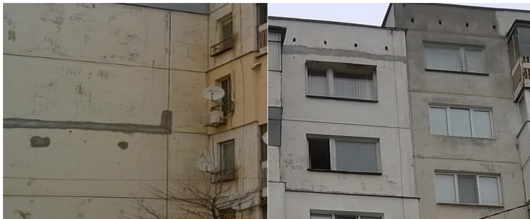
Фиг. 1.6.-Състояние на фасадни, панелни стени
