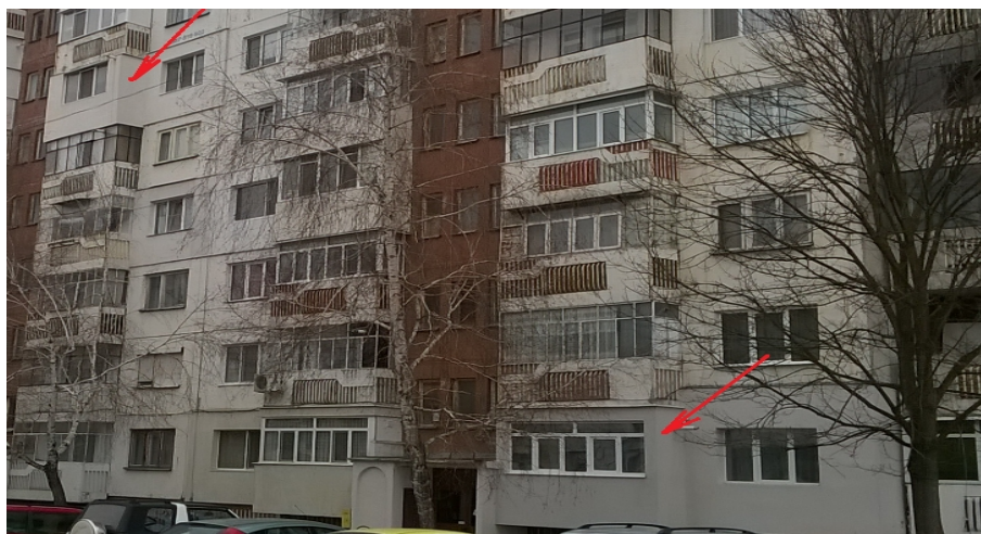
Фиг. 1.14.-Състояние на иззидана стена на приобщени и остъклени тераси с изолация над парапета
