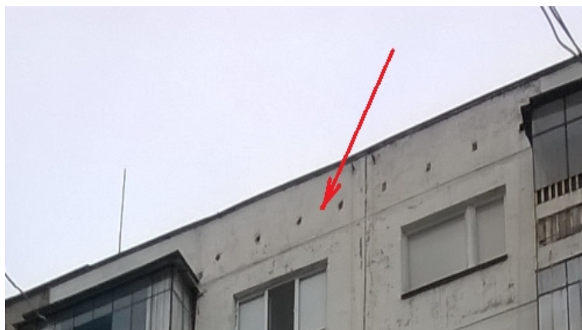
Фиг. 1.16. - състояние на покривни стени
